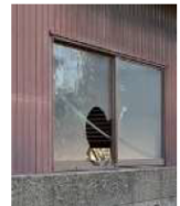
窓が割れた 管理不全空家
